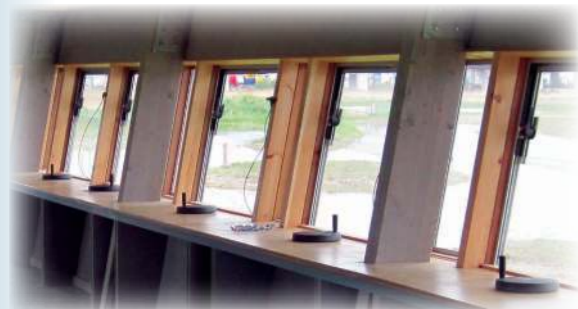
Innenansicht der Einrichtung mit den Fensterhebern, die das untere Schiebefenster steuern
